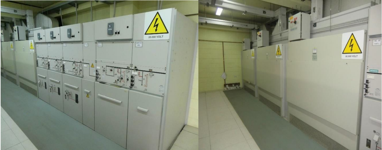
Vista generale quadro MT
